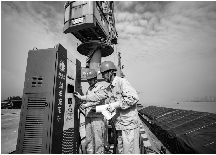
江西省瑞昌市近年来大力推进沿江码头岸电设施安装与应用，为靠岸船舶提供供电和充电服务。目前，瑞昌市13个沿江码头全部安装了岸电系统，共安装岸电系统46套。靠泊船只使用岸电后，既安全便利又清洁环保，基本可实现靠港船舶污染物“零排放”，明显改善港口周边生态环境，推动港口绿色发展。魏东升摄/中经视觉
